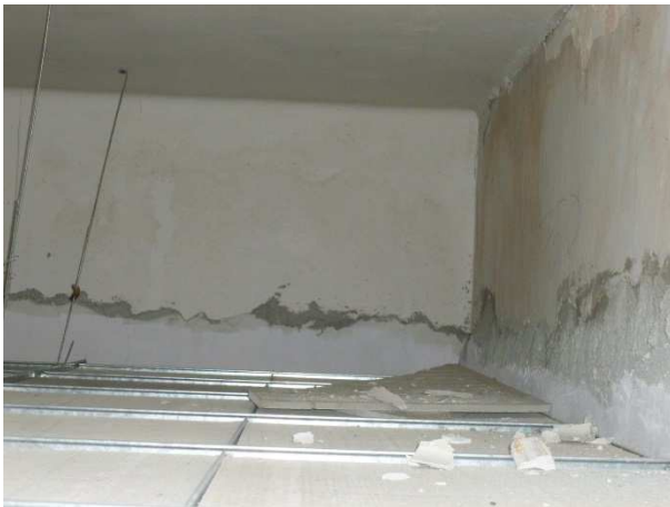
Intonaco e detriti poggianti sul controsoffitto
