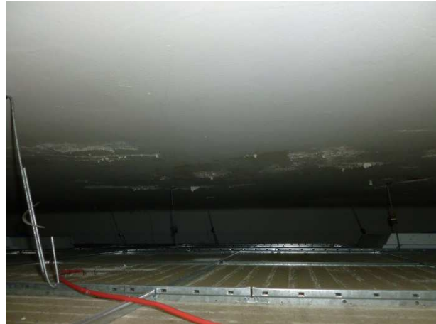
Infiltrazioni provenienti dal solaio
