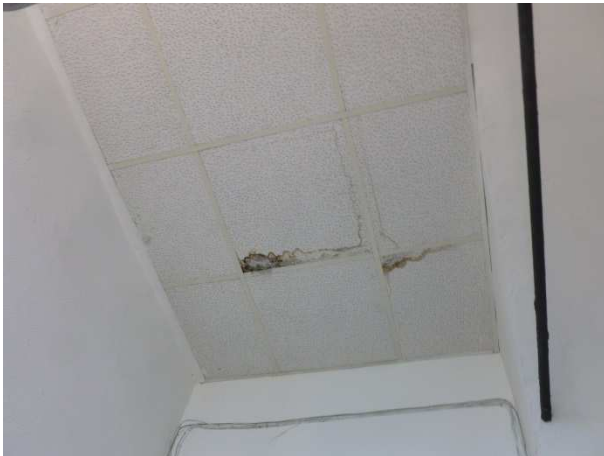
Infiltrazioni con deterioramento dei pannelli
