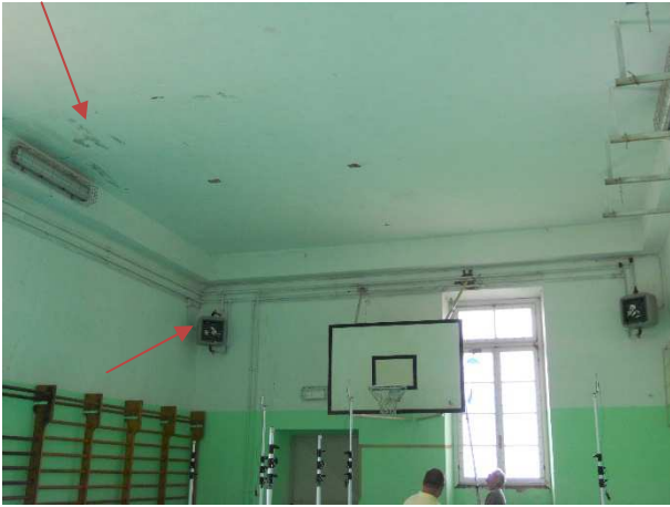
Palestra infiltrazioni e distacchi di materiale
