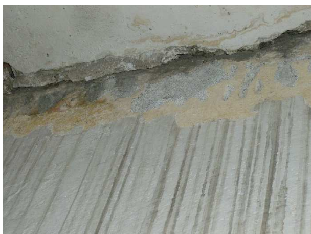
Aula A23 lesione muro- solaio
