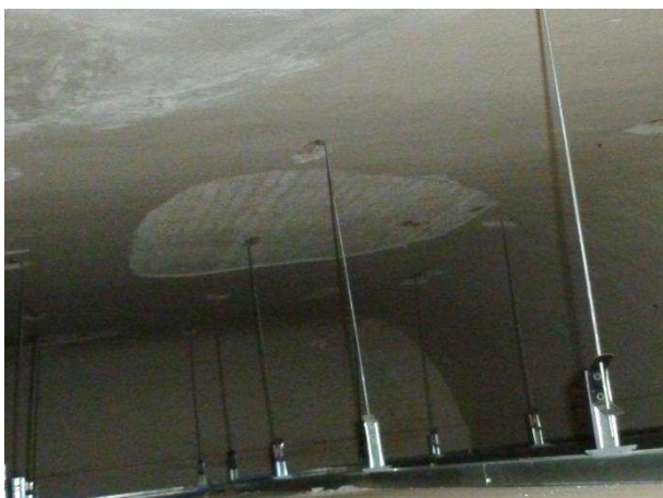
Distacchi di intonaco
