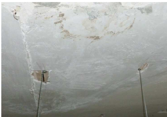
Ammaloramenti per infiltrazioni
