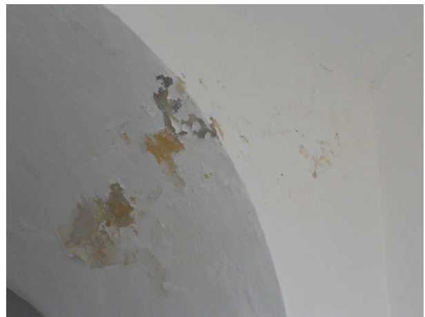
Volte corridoio distacchi di materiale
