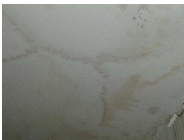
Aula A23 infiltrazioni
