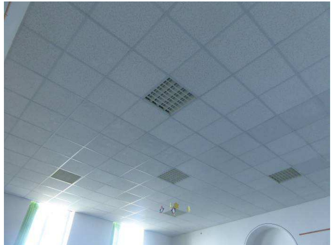
Figura 9: Aula A9 controsoffitto in lamierino e pannelli - Foto 1080284.
