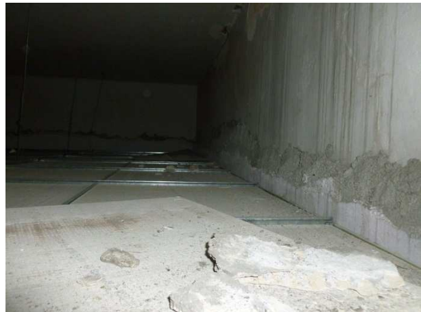
Intonaco e detriti poggianti sul controsoffitto
