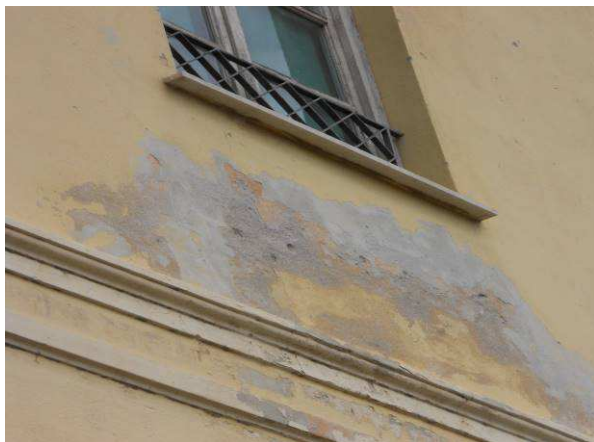
Infiltrazioni dalla facciata esterna
